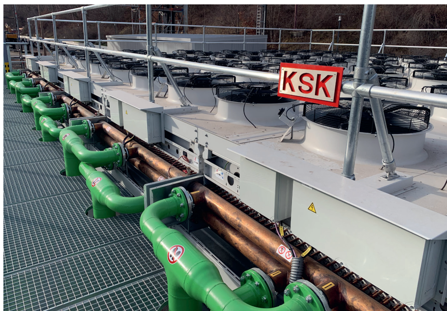
Rückkühlsystem mit Trockenkühler für wassergekühlte Rohrkonstruktionen eines Elektrolichtbogenofens, konzipiert, geliefert und in Betrieb genommen von der KSK System Kühl Technik
